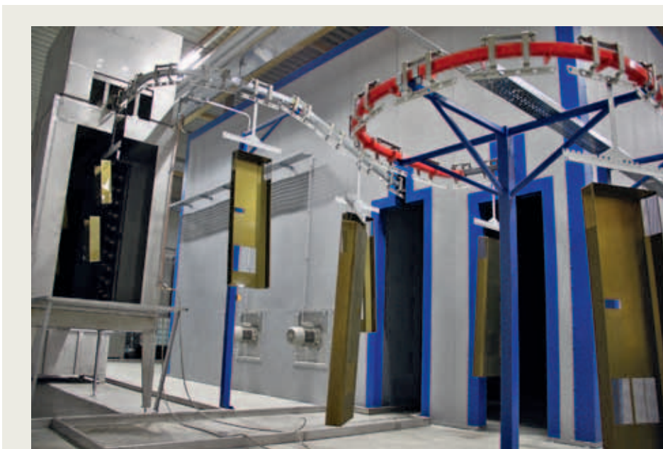
Bei der neuen multimetallfähigen 12-Zonen-Durchlauf-Vorbehandlungsanlage eines Lohnbeschichters sind einzelne Zonen zu- und wegschaltbar
